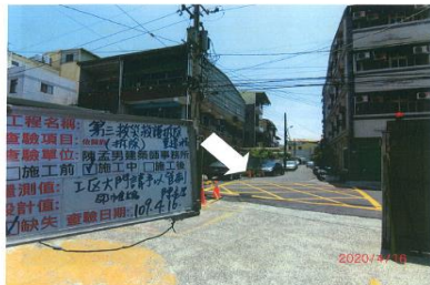
施工大門未立即封閉及管制
