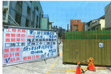
施工告示牌未固定, 請儘速安裝
