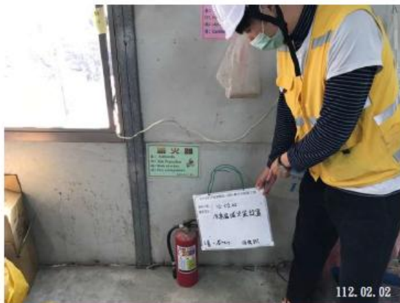
說明：休息區滅火器設置查驗
