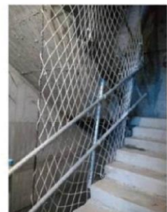
樓梯使用垂直型防墜網防護
