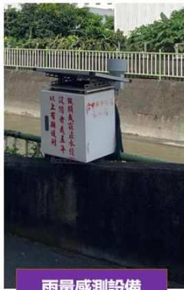
雨量感測設備
