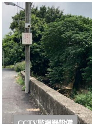
CCTV監視器設備
